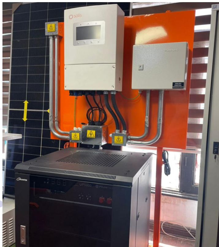
Gabinete para batería
