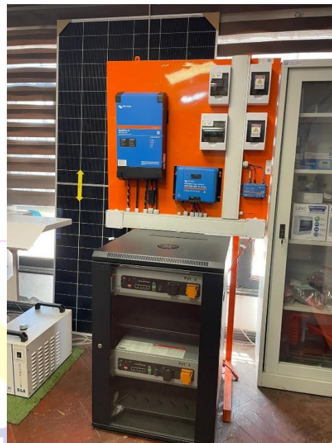
Gabinete para batería
